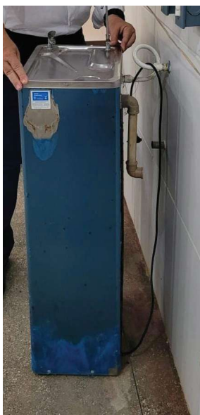
Bebedouro sem água, desconectado da rede hidráulica
